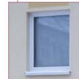
Vollwärmeschutz Ein Wärmedämmverbundsystem verbessert den u-Wert von 1,52W/m 2 K auf 0,45W/m 2 K.
